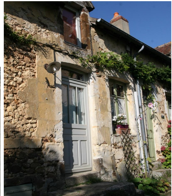
La tendance actuelle à restituer les appareillages de pierre de roussard avec le calcaire supprime les effets stylistiques originels
